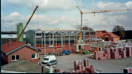
Aufbereitungshalle mit aufgestelltem Kollergang Preparation hall with installed wet pan
