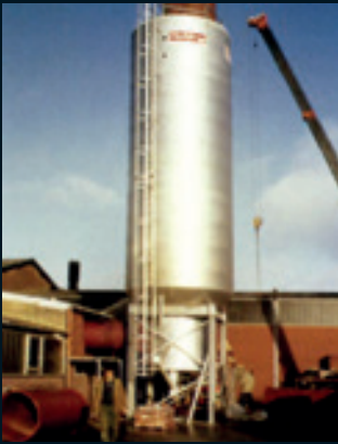
Bau der Rauchgasreinigungsanlage Flue gas purification system installed
